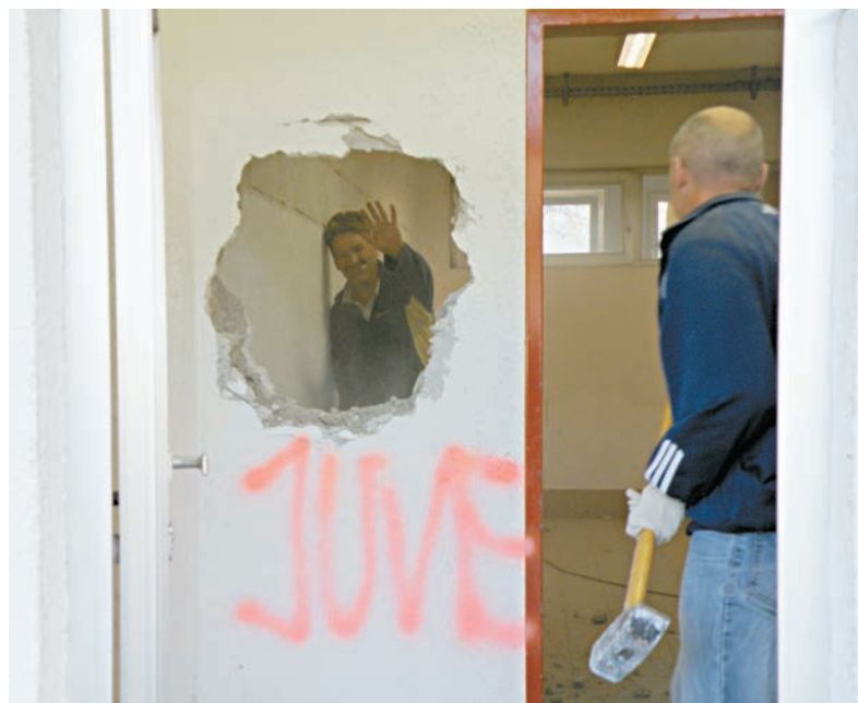
Die „alte Dame“ hat beim SV Telfs ausgedient. Fabian Noldin (hinten) und Marcel Rainer waren tatkräftig an den Sanierungsarbeiten beteiligt. Foto: Hannes Osi
